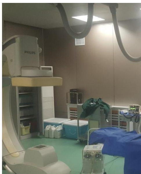
照片 5 通风换气设备
